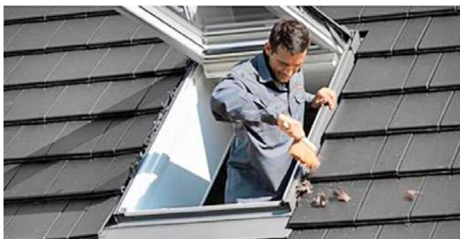
[FIG. 2] Risque accru d'infiltration d'eau aux raccords en raison de l'encrassement.
