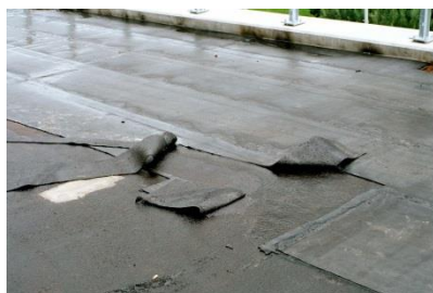
Image 1 : Étanchéité LPB avec une très faible adhérence. Juste après la pose la liaison était bonne, mais le lendemain, elle était totalement insuffisante.
