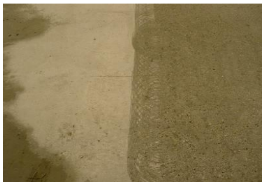
Côté gauche non traité, côté droit sablé à l'eau sous haute pression 1000 bars. Résultat : l'adhérence est toujours insuffisante.
